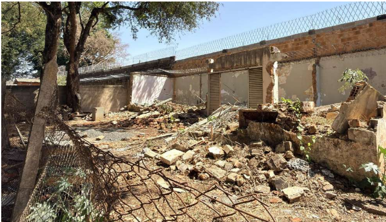
Figura 42 - Vista área fundo, destroços de uma construção, divisa lote fundo
