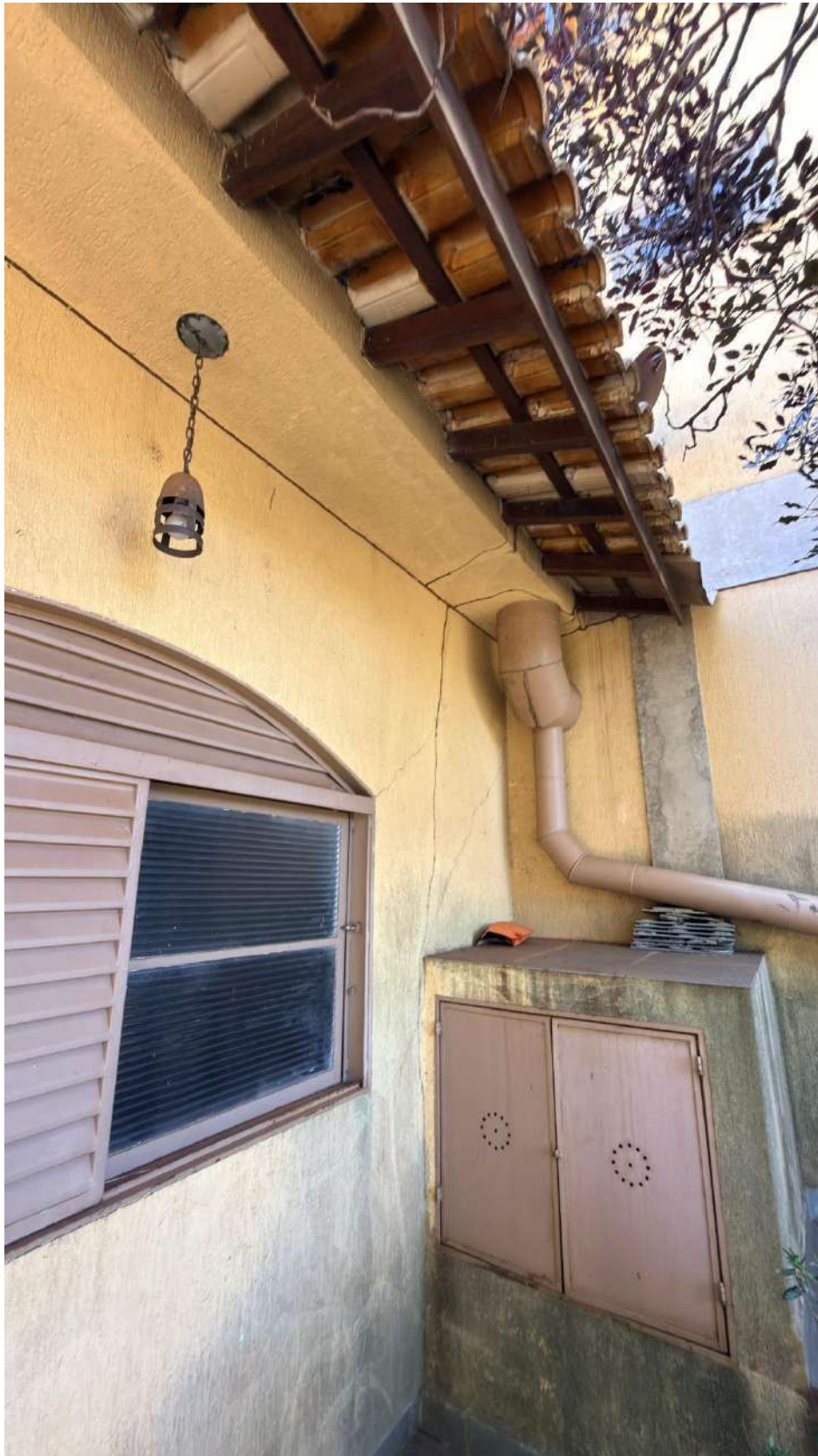
Figura 12 - Edícula com avarias, trincas e fissuras
