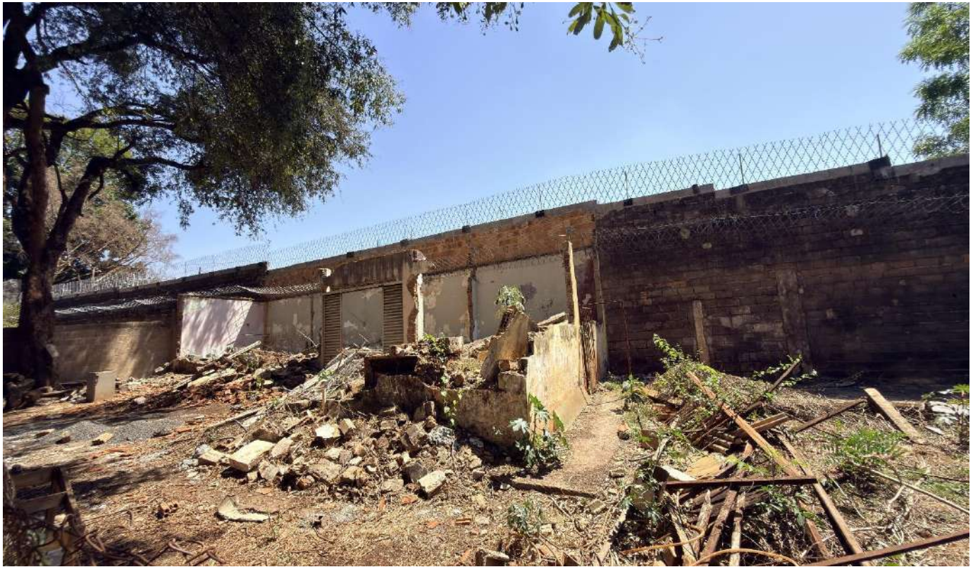
Figura 41 - Vista área fundo, destroços de uma construção, divisa lote fundo
