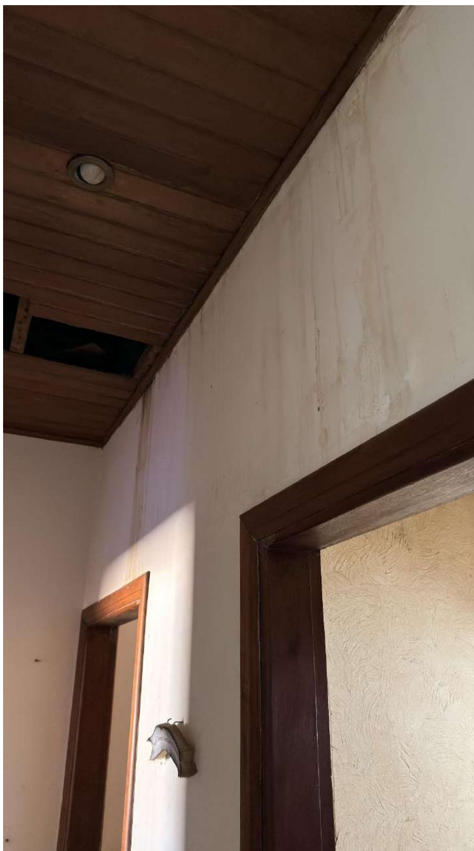
Figura 72 - Caixa d'água vazando
