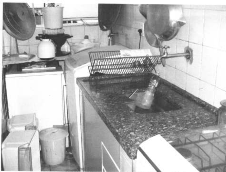
Foto 6 – Detalhe da cozinha do apartamento periciado
